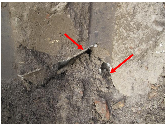
Bild 11: Detail zu Bild 10, Asbestzementbruch
